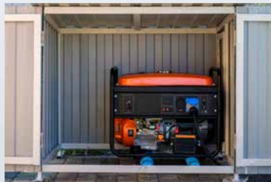
Generador de emergencia estacionario Stationary emergency generator
